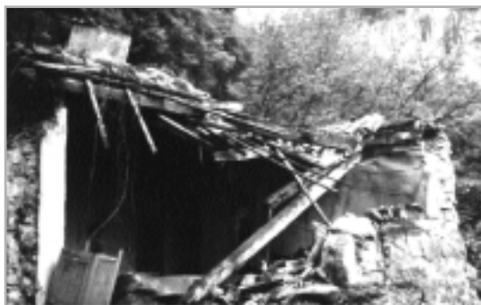
Slika 3.11: Porušena hiša v Ospu: kdo so lastniki ruševine in kje so?
